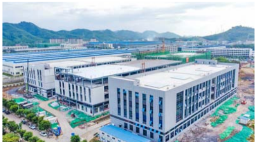
瑞金经开区标准厂房项目已完成2#楼主体结构封顶，3#楼主体结构施工，4#、5#楼钢结构外墙板安装，6#楼装饰装修阶段
