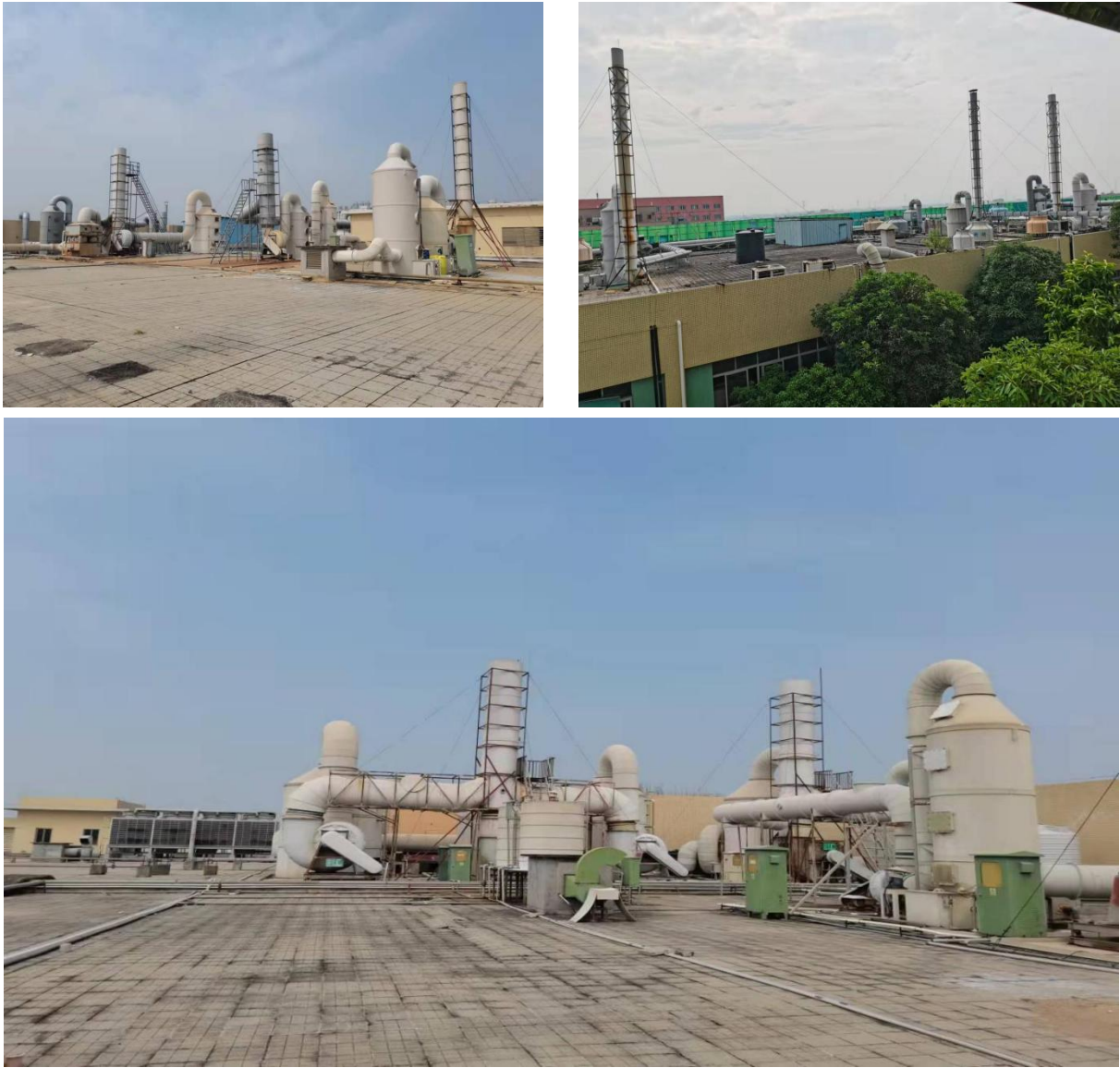
图 4.5-5 废气治理设施
