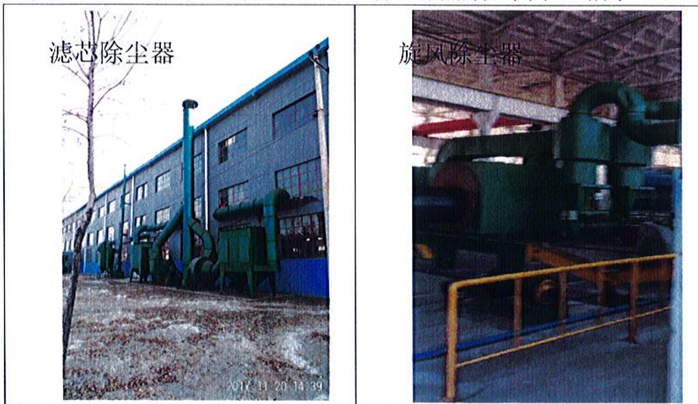
图 3-4 内抛丸工序旋风除尘器、滤芯除尘器现场照片
