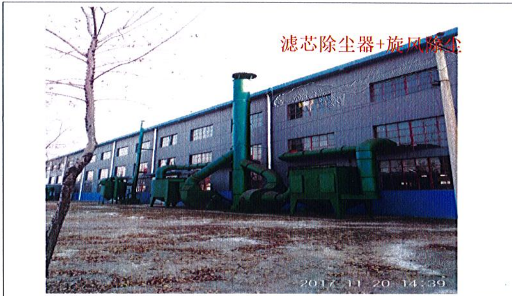
图 3-5 上砂工序旋风除尘器、滤芯除尘器现场照片
