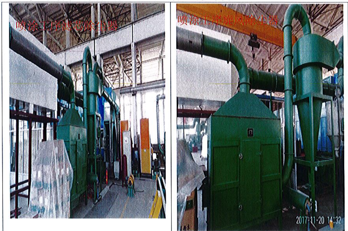
图 3-2 喷涂工序滤芯除尘器、旋风除尘器现场照片
