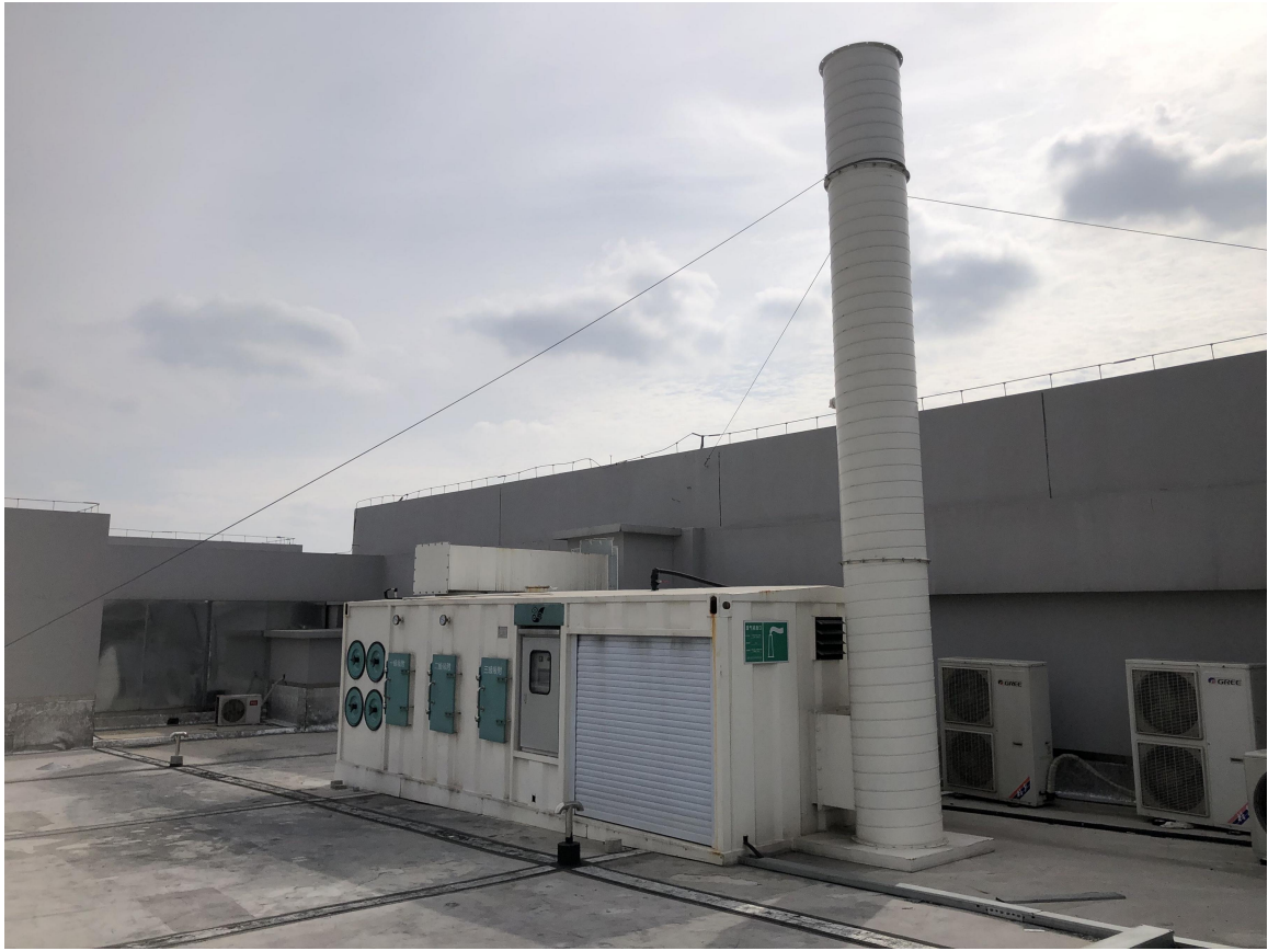
FQ-1 废气处理设施
