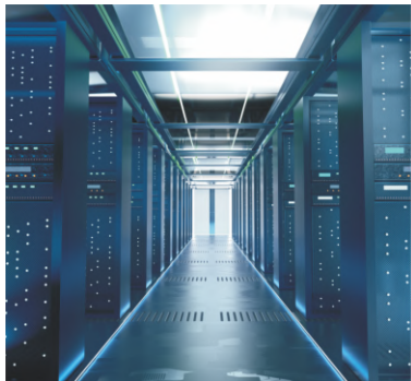
模块化数据机房
