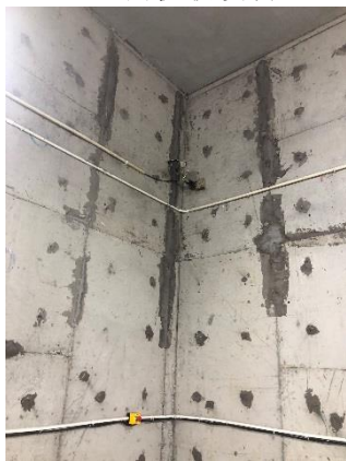
(7) 探伤室内监控装置
