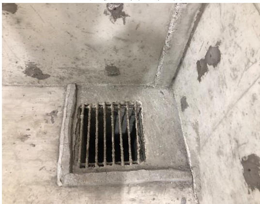
(9) 探伤室内排风口
