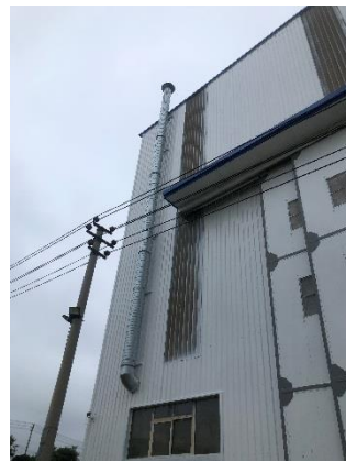
(14) 探伤室通风系统
