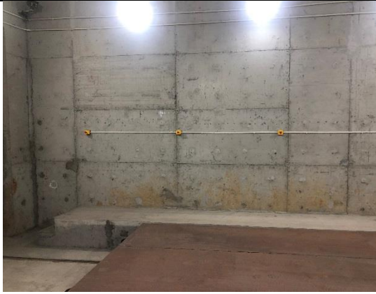
(3) 探伤室内急停开关
