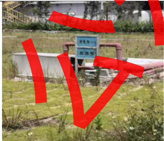
事故应急池 1 应急泵
