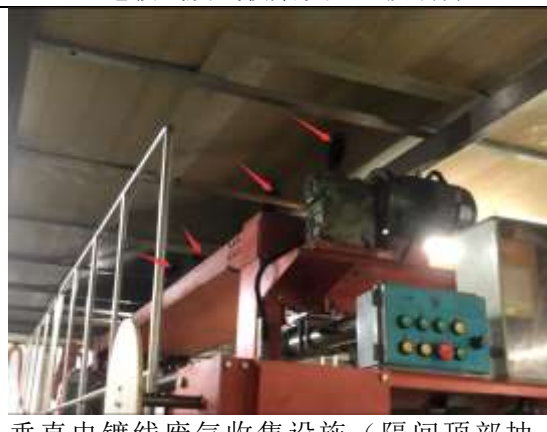
垂直电镀线废气收集设施（隔间顶部抽排）
