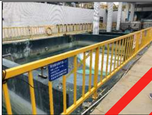
综合废水调节池
