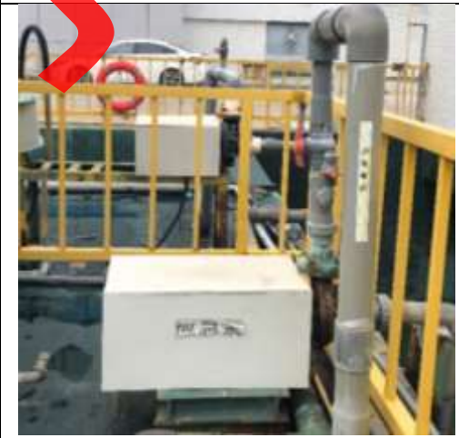
事故应急池 2 应急泵
