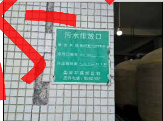
综合废水排放口 2
