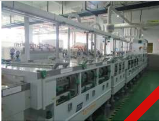
水平线废气收集管
