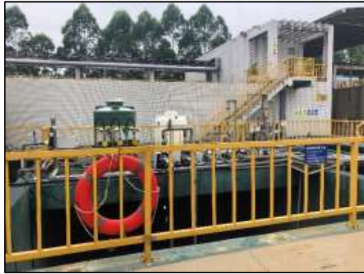
磨板废水调节池
