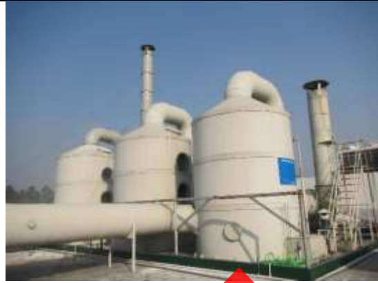
酸碱雾喷淋塔
