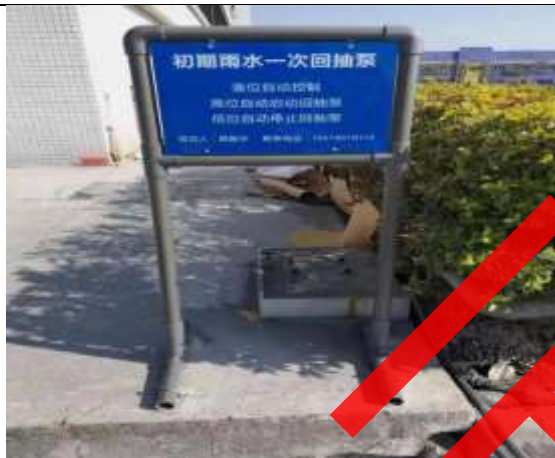
厂内装卸区初期雨水回抽泵
