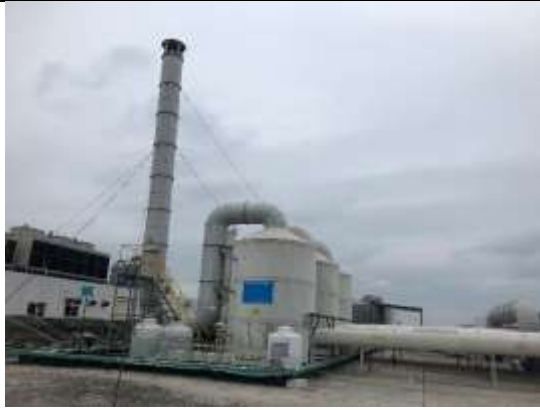
酸碱雾喷淋塔
