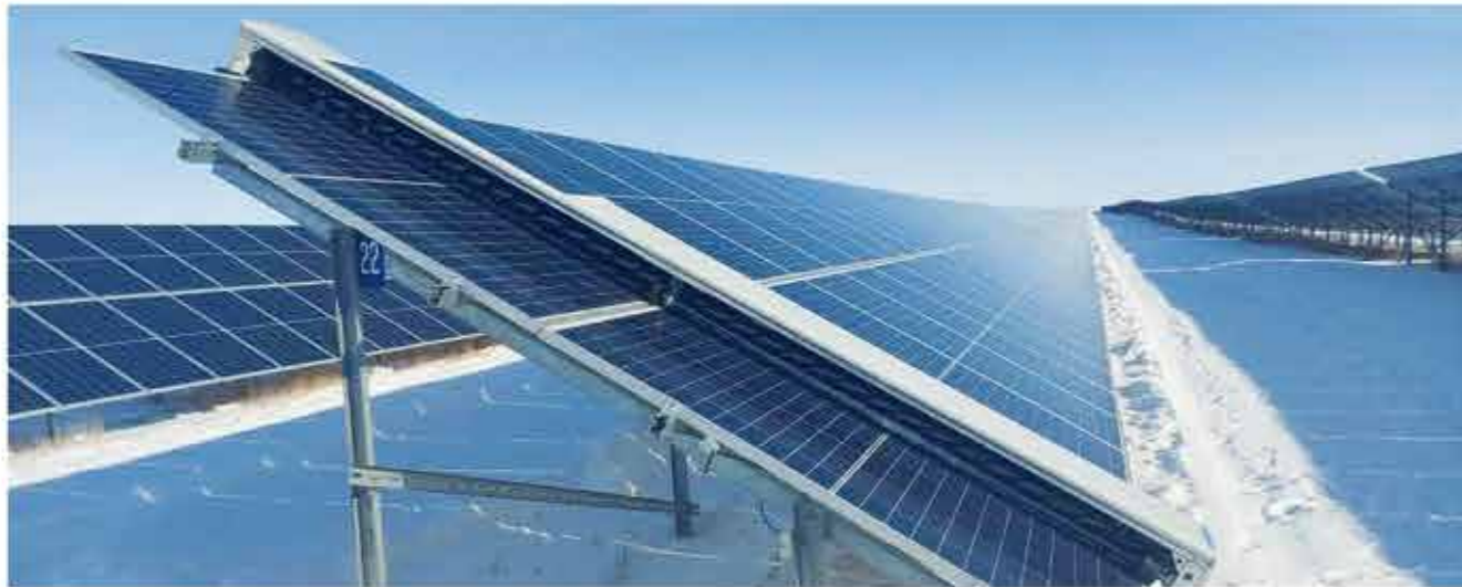
海外项目 Overseas projects 哈萨克斯坦光伏电站项目 PV project in Kazakhstan
