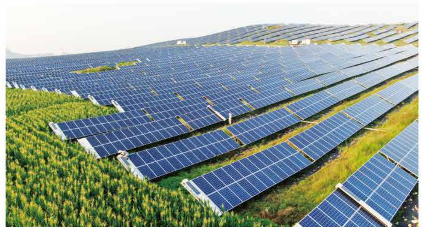
农光互补 Agriculture 萧县宜光20MW农光互补光伏发电项目 Xiao county 20MW agricultural PV plant
