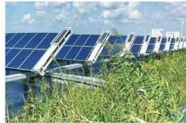
渔光互补 Fisheries 江苏泗洪110MW光伏电站项目 Sihong 110MW PV project
