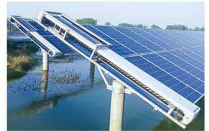
安徽金阳100MW光伏电站项目 Jinyang 100MW PV project
