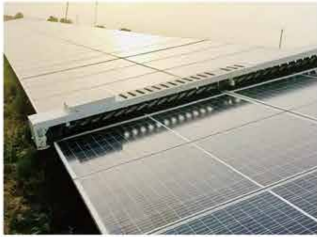
海外项目 Overseas projects 印度光伏电站项目 PV project in India
