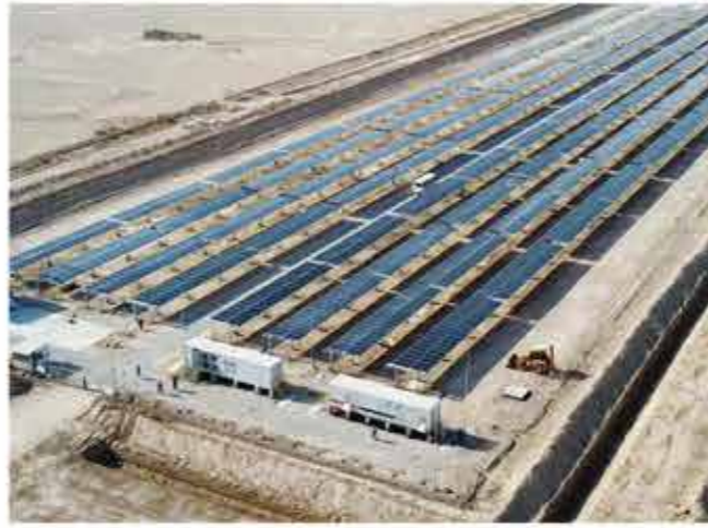
海外项目 Overseas projects 伊拉克光伏电站项目 PV project in Iraq
