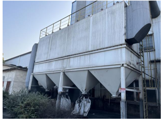
2#砂处理废气处理措施及排放口
