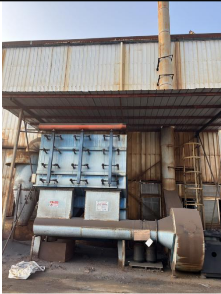
打磨废气处理措施及排放口
