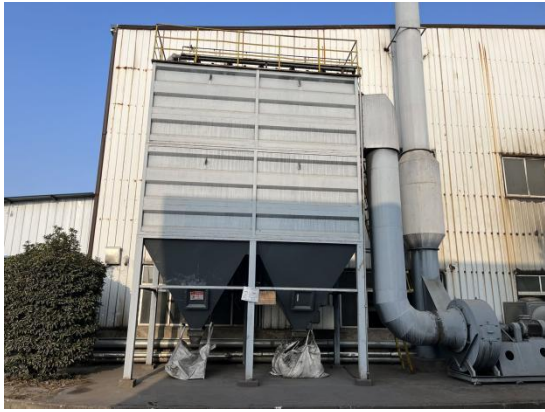
中频炉熔炼废气处理措施及排放口
