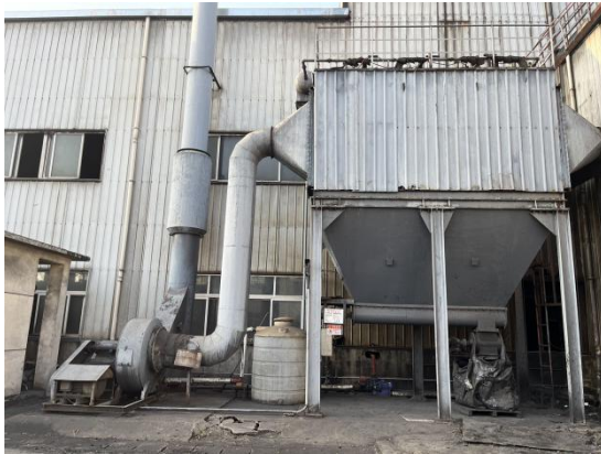
1#砂处理废气处理措施及排放口
