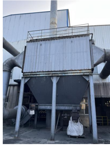
混砂造型废气处理措施及排放口
