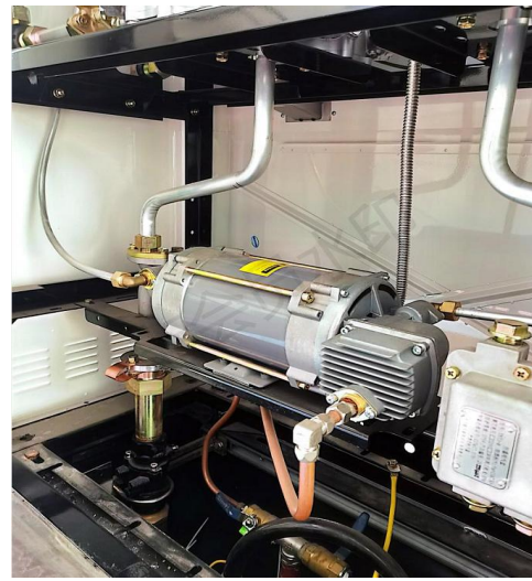
加油油气回收装置
