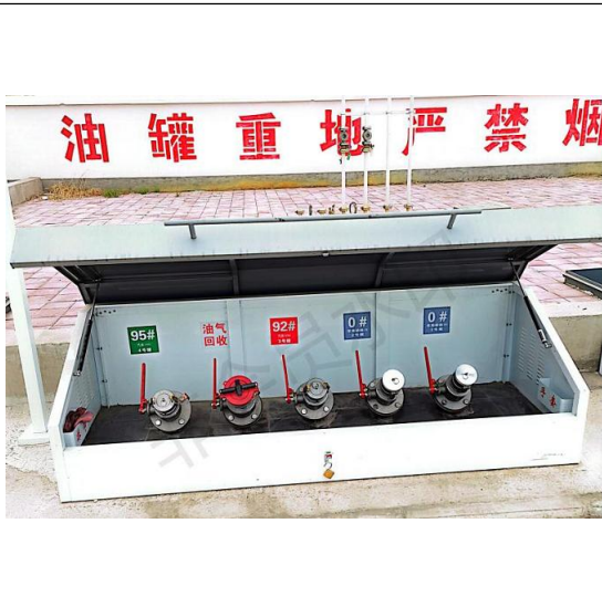
卸油油气回收装置
