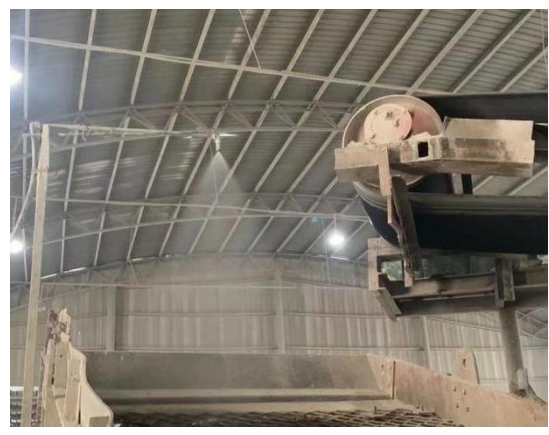
破碎筛分工序喷淋装置
