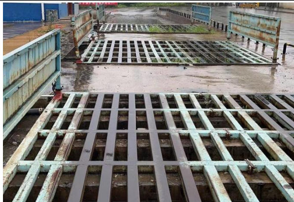
车辆清洗沉淀池
