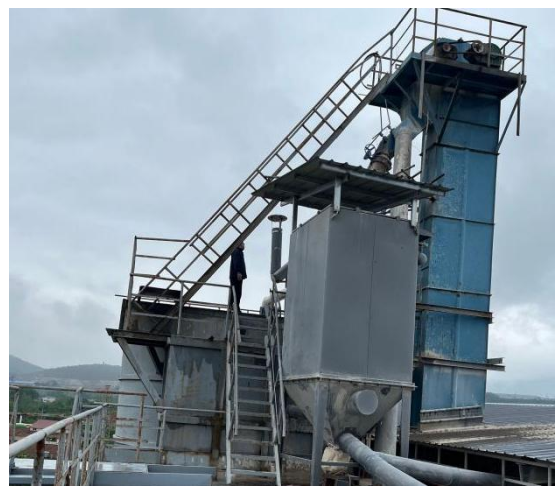
罐仓顶脉冲布袋除尘器
