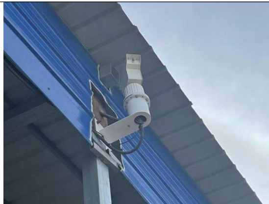
厂房外喷淋装置
