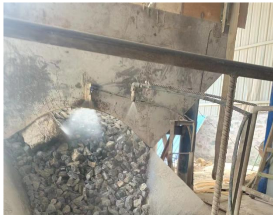
破碎筛分工序喷淋装置
