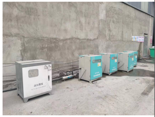
高压喷雾系统
