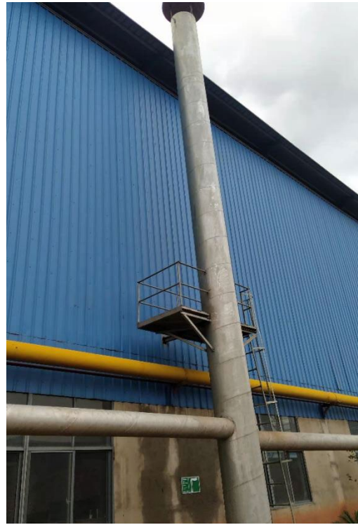
天然气退火炉排气筒
