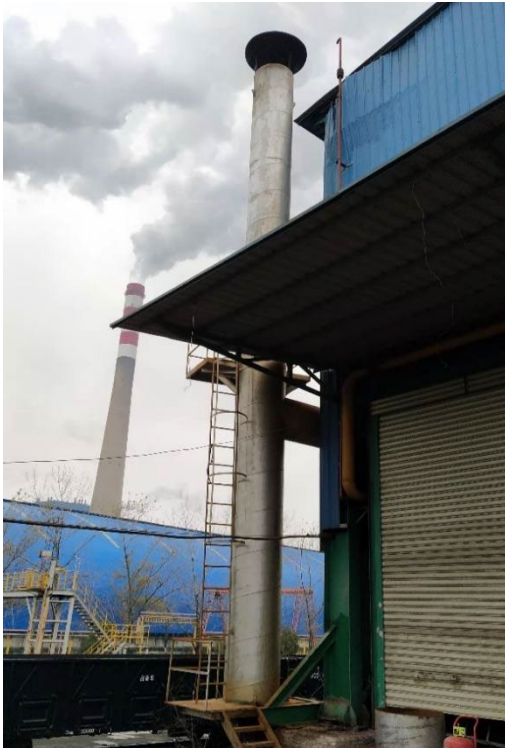
天然气加热炉排气筒
