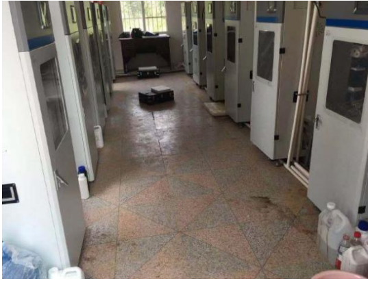
废水在线监控室内部
