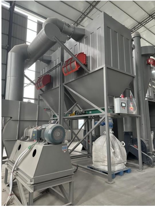
废电路板无害化处理生产线布袋除尘器
