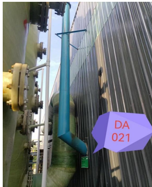
蒸汽发生器燃烧废气排气筒 (DA021)
