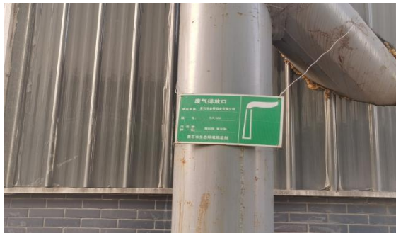
布袋除尘处理设施及排放口标识牌
