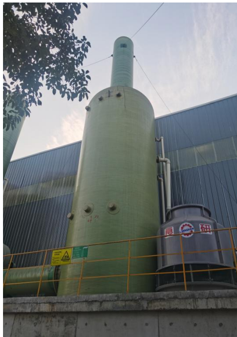
酸性气体排气筒(DA019)
