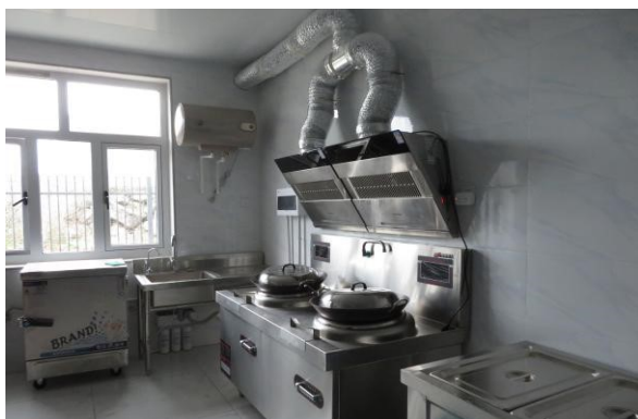
升压站厨房油烟净化装置
