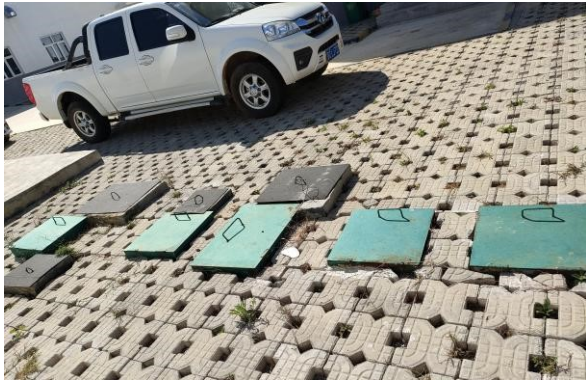
站区生活污水处理系统
