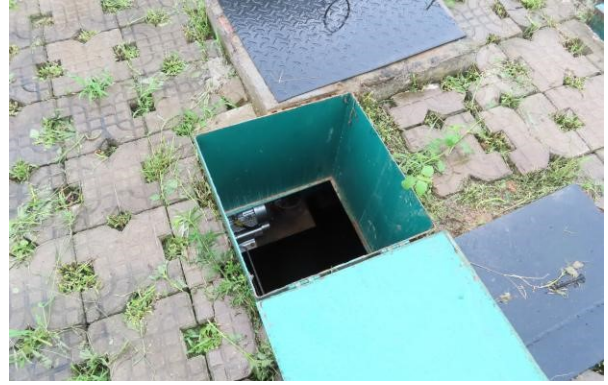
站区生活污水处理系统
