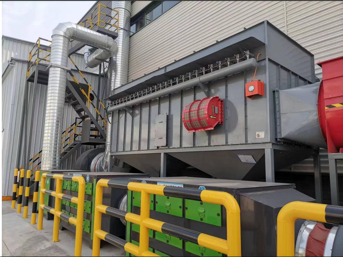
1#活性炭吸附装置、3#布袋除尘器
