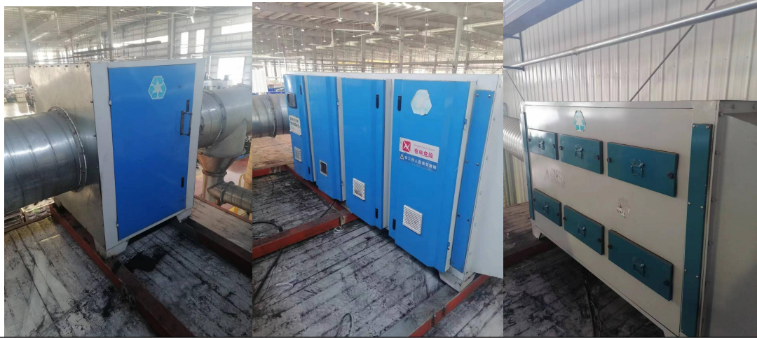
2#过滤棉箱干式+UV 光解装置+2#活性炭吸附装置
