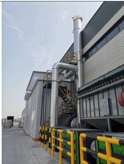
抛丸、焊接排气筒 P6
