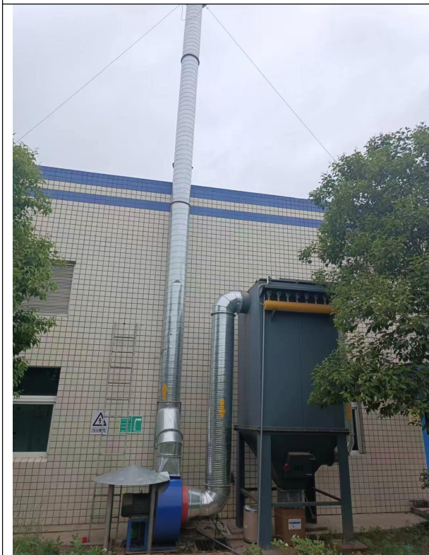
粉剂车间颗粒物处理设备
