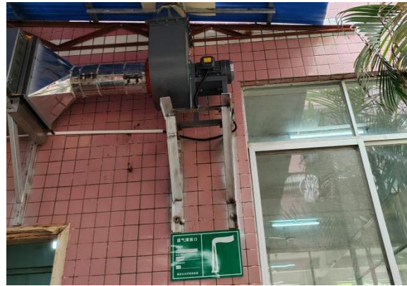
废气排放口 DA004
