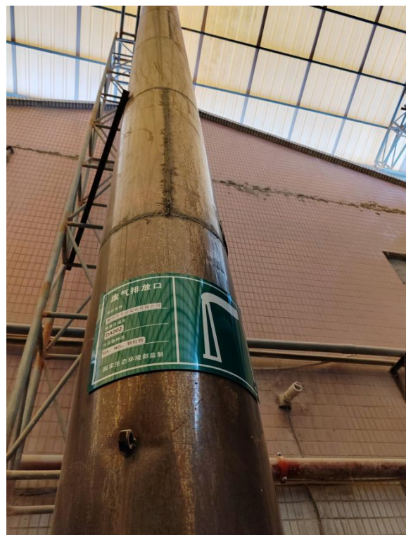
废气排放口 DA002
