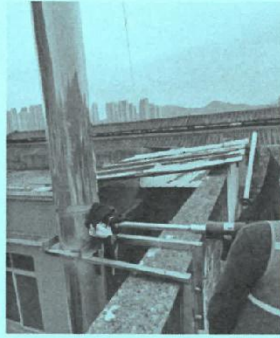
食堂油烟处理后采样口
