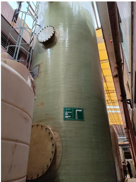
废气排放口 DA001
