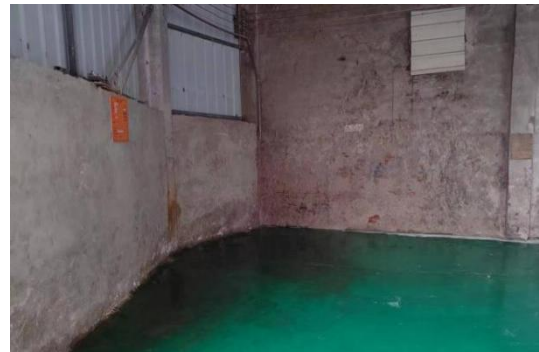
危险废物暂存区
