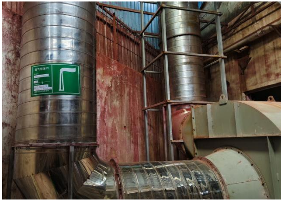
废气排放口 DA003
