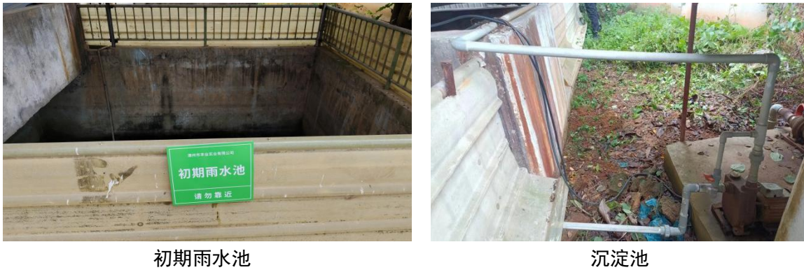
图 4.1-1 废水处理设施现场图
