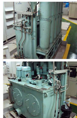
海上钻井平台燃烧臂液压系统使用现场/on-site usage
