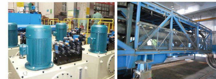
城市垃圾中转压缩站液压系统及使用现场
