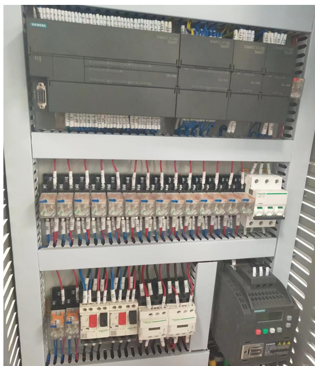
▲万锐压机电气系统，采用欧洲品牌元器件，保障稳定性
