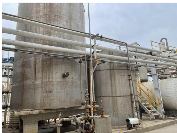
DM 装置区 M 钠盐溶液储罐
