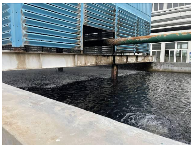
冷却循环水池 2
