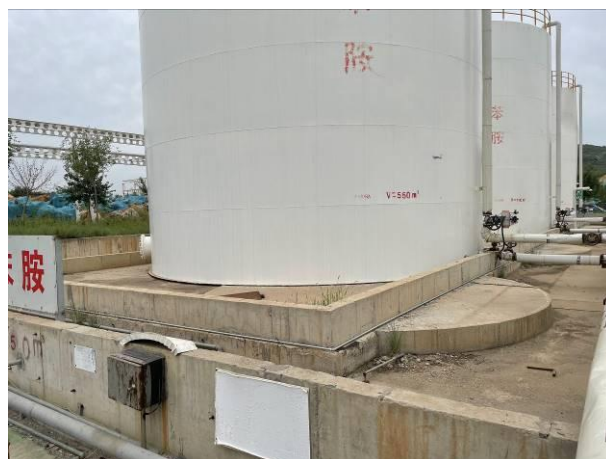
罐区苯胺储罐
