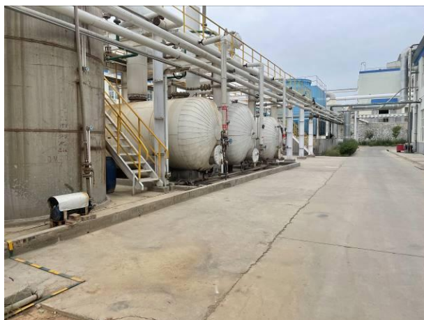
M 装置区物料管道输送
