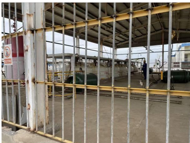
通氯棚内液氯储罐
