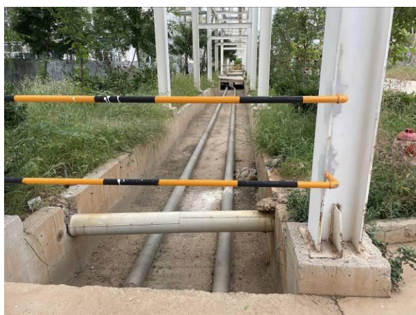
厂区污水管道（银黑色管道）
