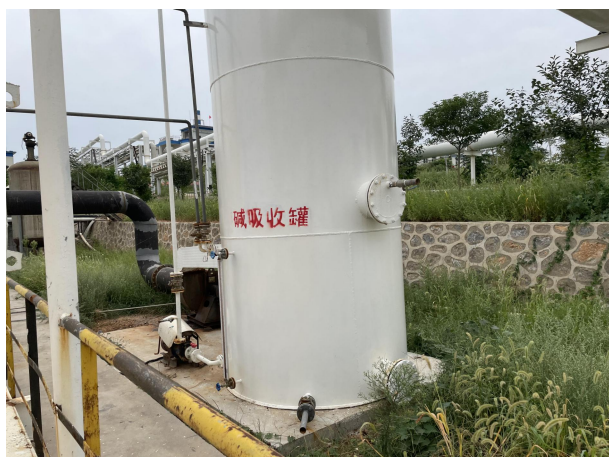
污水预处理区碱吸收罐
