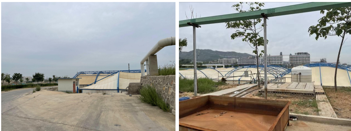
污水处理池（加盖封闭）
