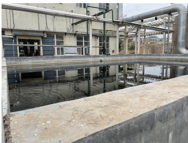
冷却循环水池 1
