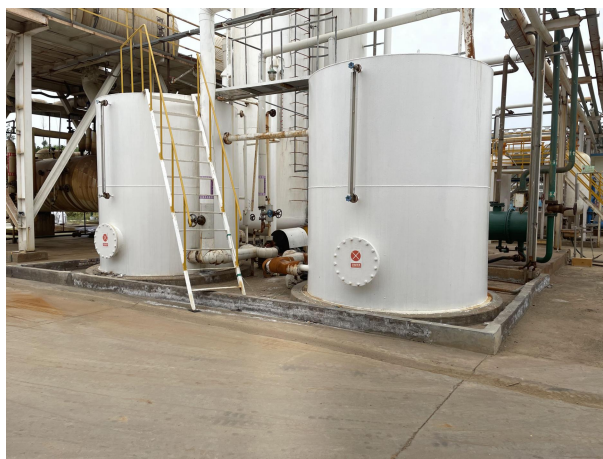
硫磺回收区硫磺缓冲罐
