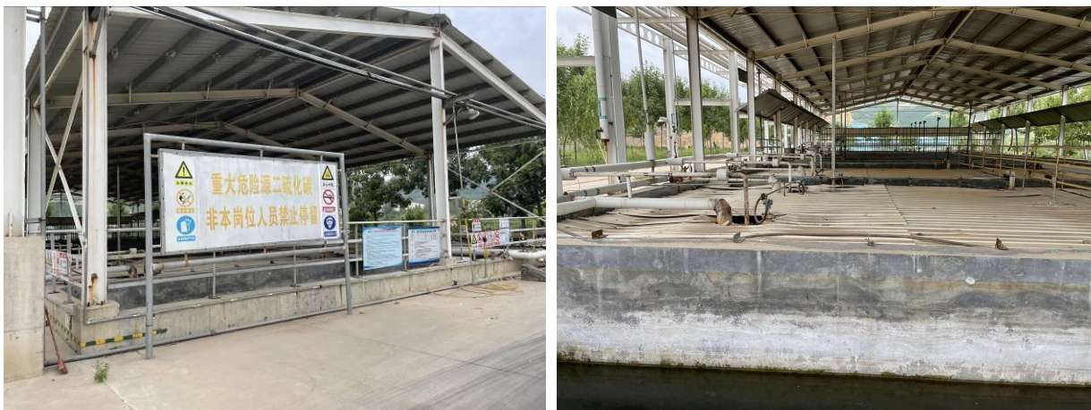
地下罐区（含双氧水、二硫化碳、环己胺、叔丁胺、甲苯储罐）
