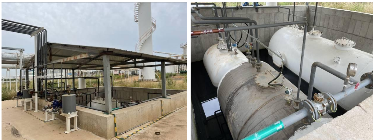
硫磺回收区二硫化碳储罐
