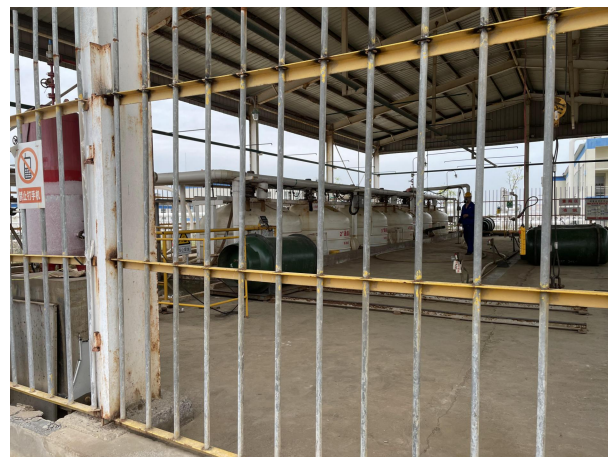
次钠生产装置
