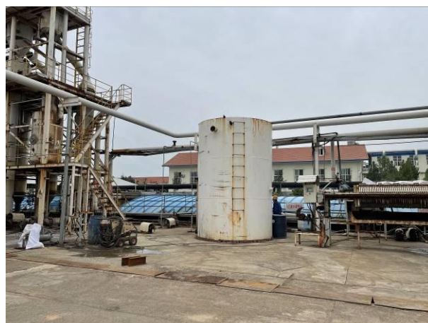
废水预处理罐
