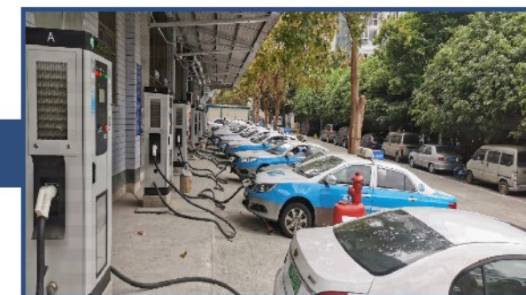
厦门XXX(福光大厦)充电站 160KW双枪直流桩+200KW双枪直流桩 18台, 合计总功率4520KW
