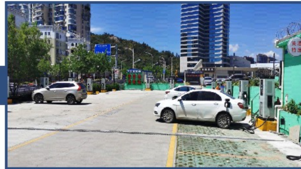
厦门(火车站南路)充电站 120KW双枪直流桩 16台,合计总功率1920KW
