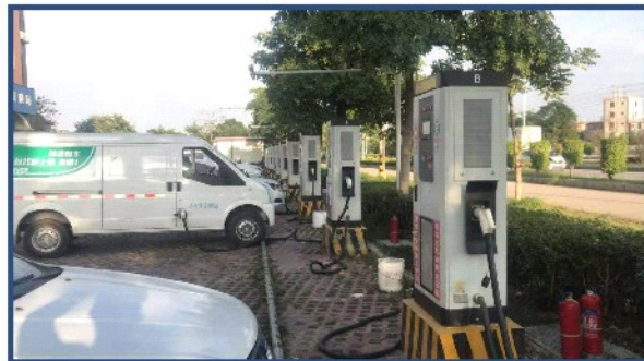
惠安XXX充电站 120KW双枪直流桩+80KW单枪直流桩 11台,合计总功率1280KW
