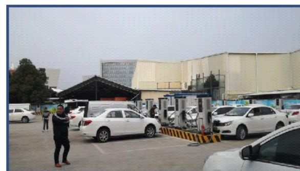
厦门XX(高崎)充电站 120KW双枪直流桩 46台, 合计总功率5520KW
