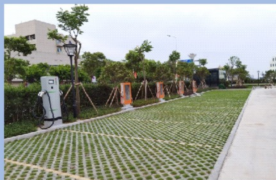
XXXX机场空管站专用桩 60KW双枪直流桩+14KW多媒体广告桩 5台, 合计总功率116KW
