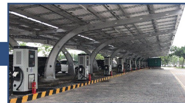
厦门XXX(长庚医院)充电站 120KW双枪直流桩+160KW双枪直流桩 33台, 合计总功率4120KW
