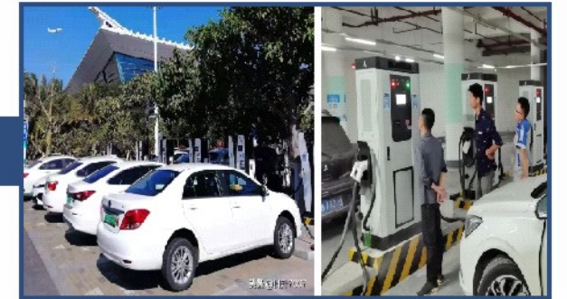
厦门XX(高崎机场T3/T4)充电站 120KW双枪直流桩+160KW双枪直流桩+360KW一拖六枪分体桩 28台,合计总功率4080KW
