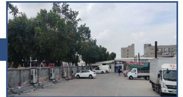
厦门XX(杏林)充电站 120KW双枪直流桩 9台,合计总功率1080KW
