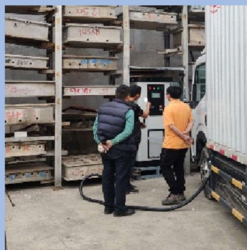
Xx集装箱工厂专用桩 120KW双枪直流桩 1台, 合计总功率120KW
