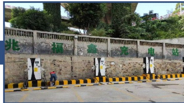
厦门XX(古玩城)充电站 160KW双枪直流桩 10台,合计总功率1600KW
