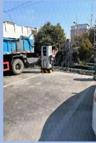
开封龙亭环卫所专用充电站 120KW双枪直流桩, 60KW单枪直流桩7台, 合计总功率1500KW
